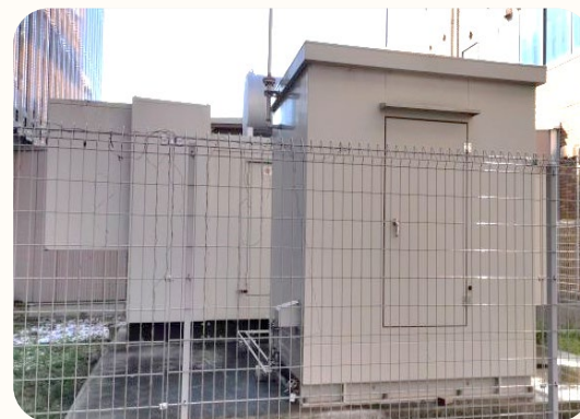
自家発電設備
